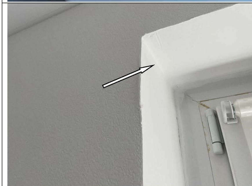
Фото №23. Окрашивание откосов в спальне выполнено с дефектами.
