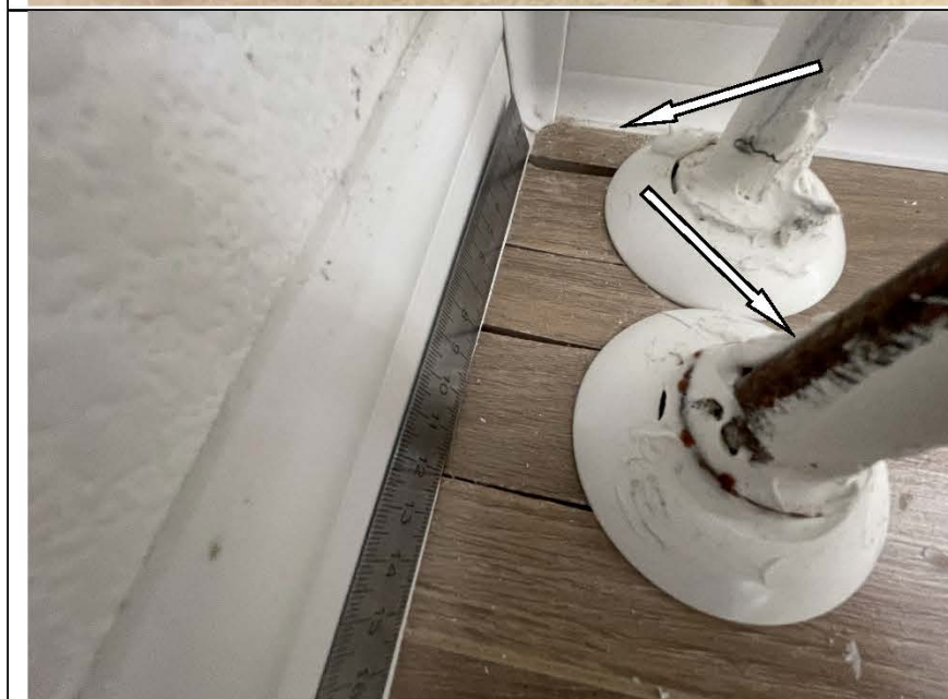
Фото №18. Трубы отопления в кухне окрашены с дефектами. Дефект заделки отверстия для трубопровода отопления в напольном покрытии в кухне.
