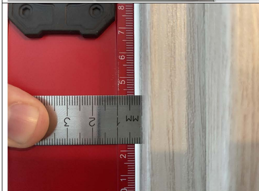
Фото №35. Отклонение дверного блока в спальне.
