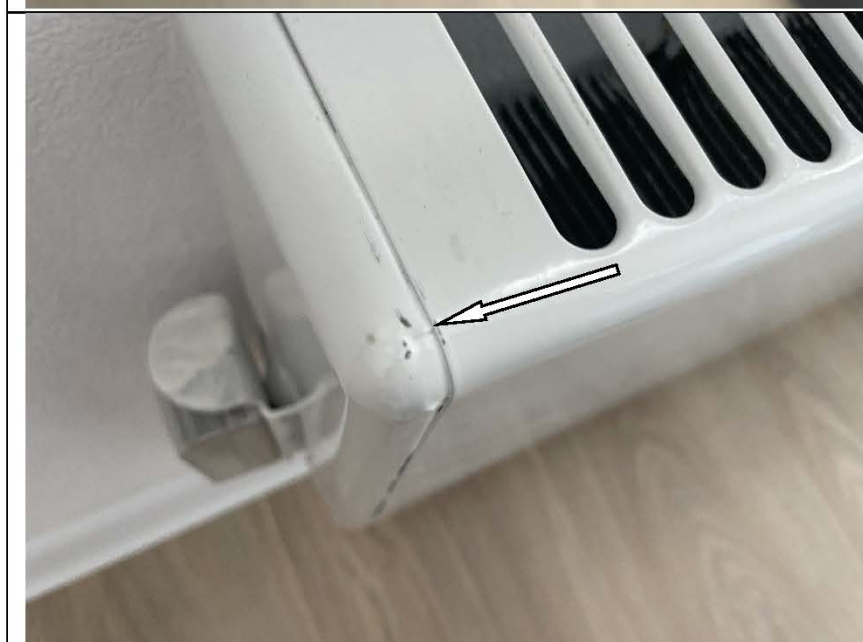
Фото №42. Кожух отопительного прибора в спальне имеет сколы.
