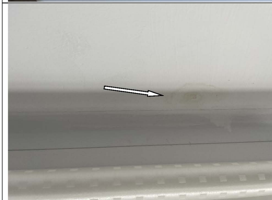
Фото №45. Следы протечки на откосе оконного блока в спальне.
