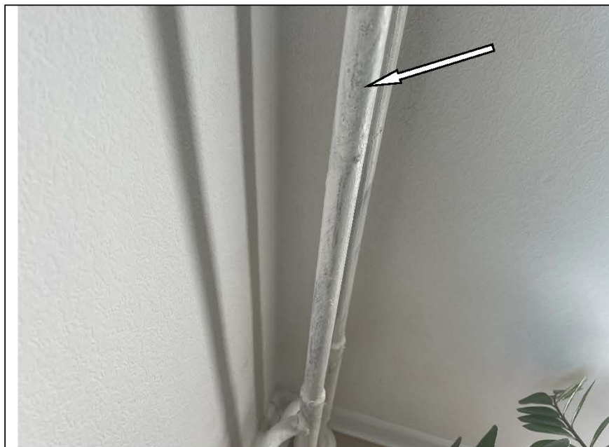
Фото №19. Трубы отопления в спальне окрашены с дефектами.
