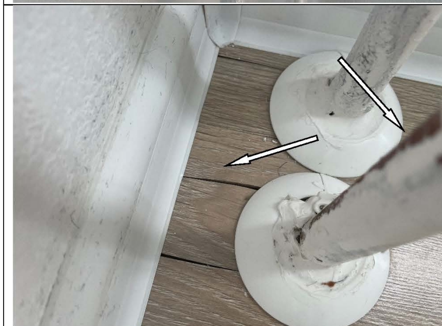
Фото №21. Дефект заделки отверстия для трубопровода отопления в напольном покрытии в спальне. Трубы отопления в спальне окрашены с дефектами.
