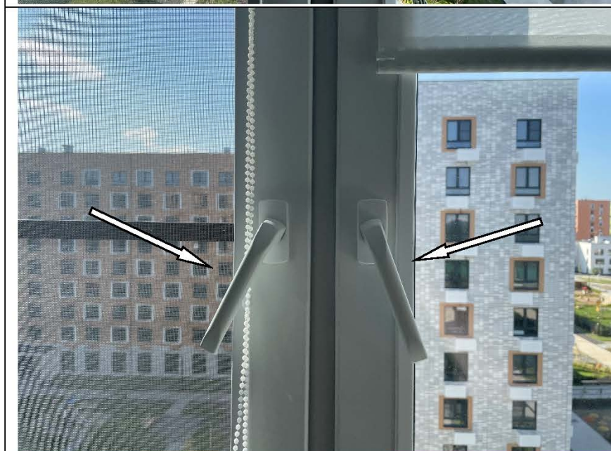
Фото №26. Фурнитура оконного блока ПВХ в спальне не отрегулирована.
