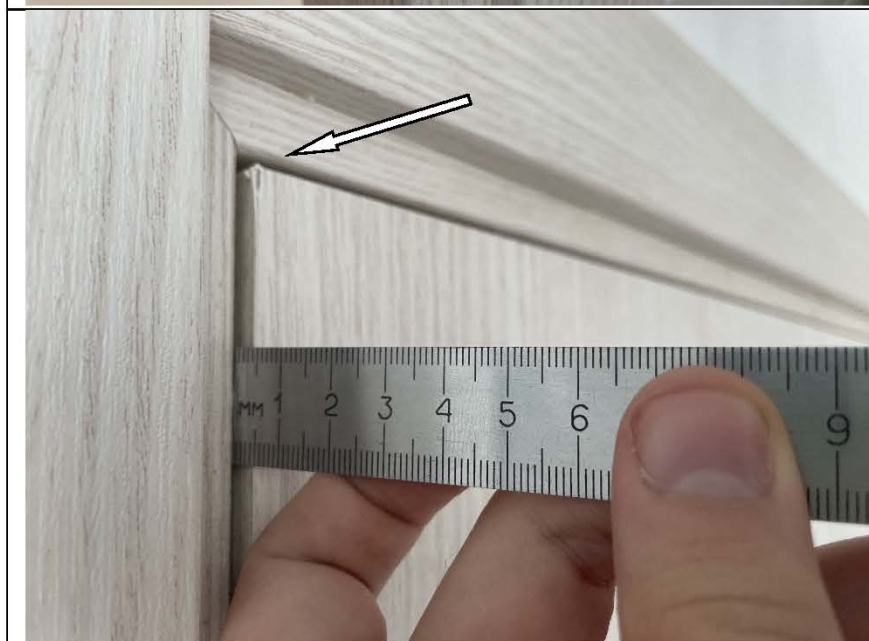
Фото №39. Дверь в спальне не закрывается до конца. Повреждение полотна двери.
