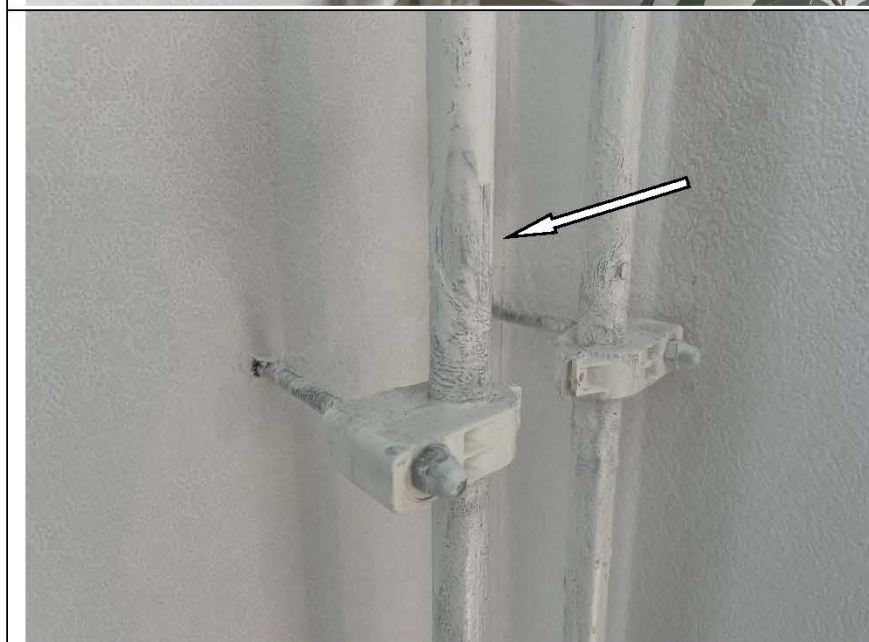
Фото №20. Трубы отопления в детской окрашены с дефектами.
