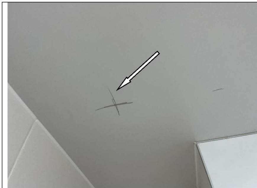
Фото №34. Окрашенный потолок в санузле загрязнен.
