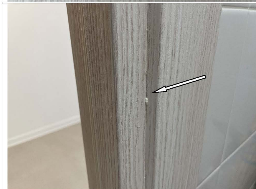
Фото №38. Загрязнение наличника в санузле.
