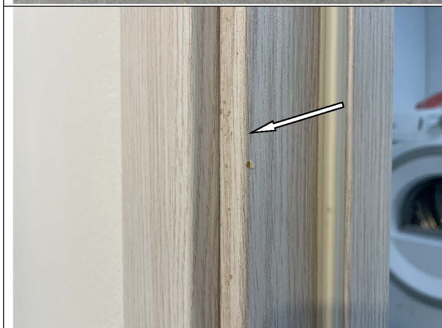
Фото №50. Скол и загрязнения на дверном блоке в ванной комнате.
