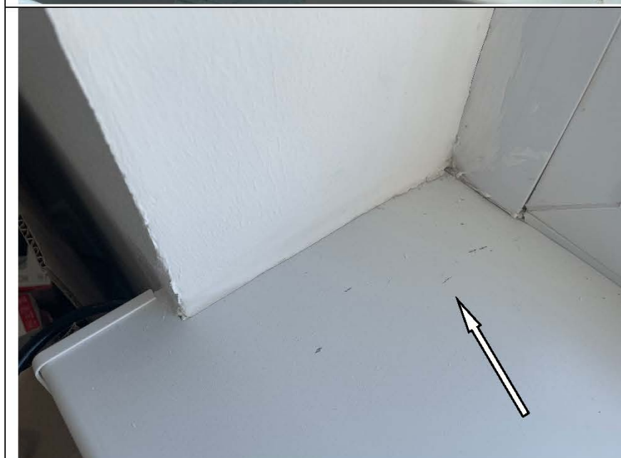
Фото №44. Загрязнения на подоконнике в спальне.
