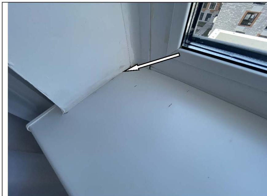
Фото №22. Окрашивание откосов в кухне выполнено с дефектами.
