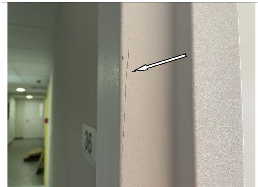
Фото №55. Царапина на блоке входной двери.
