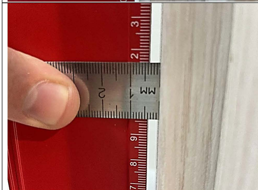
Фото №36. Отклонение дверного блока в ванной комнате.
