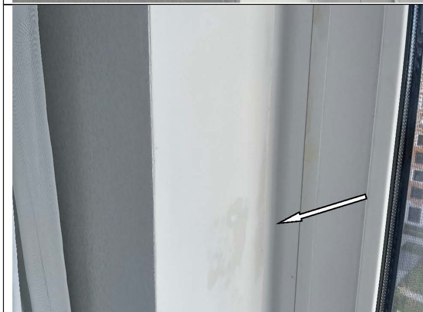
Фото №24. Окрашивание откосов в детской выполнено с дефектами.
