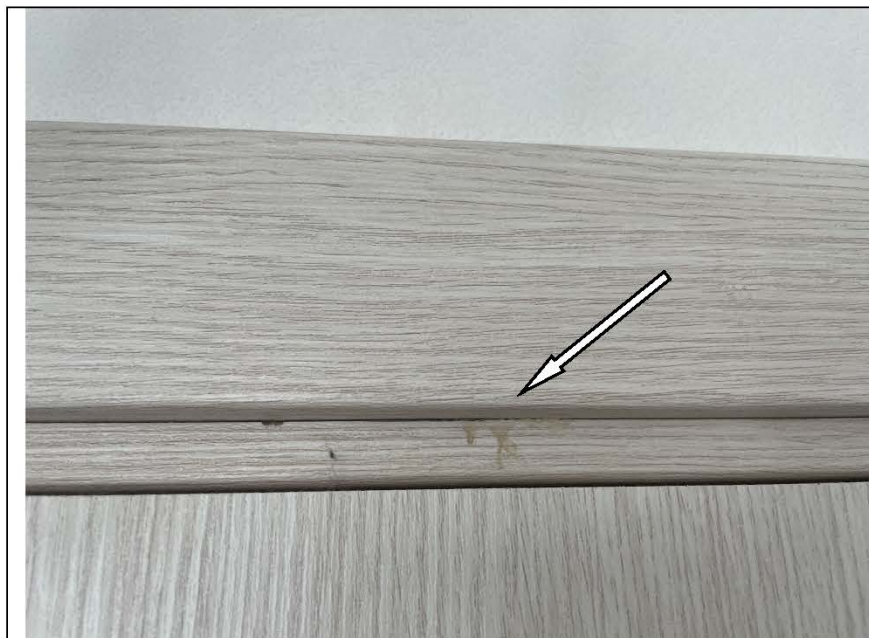
Фото №37. Загрязнение наличника в спальне.
