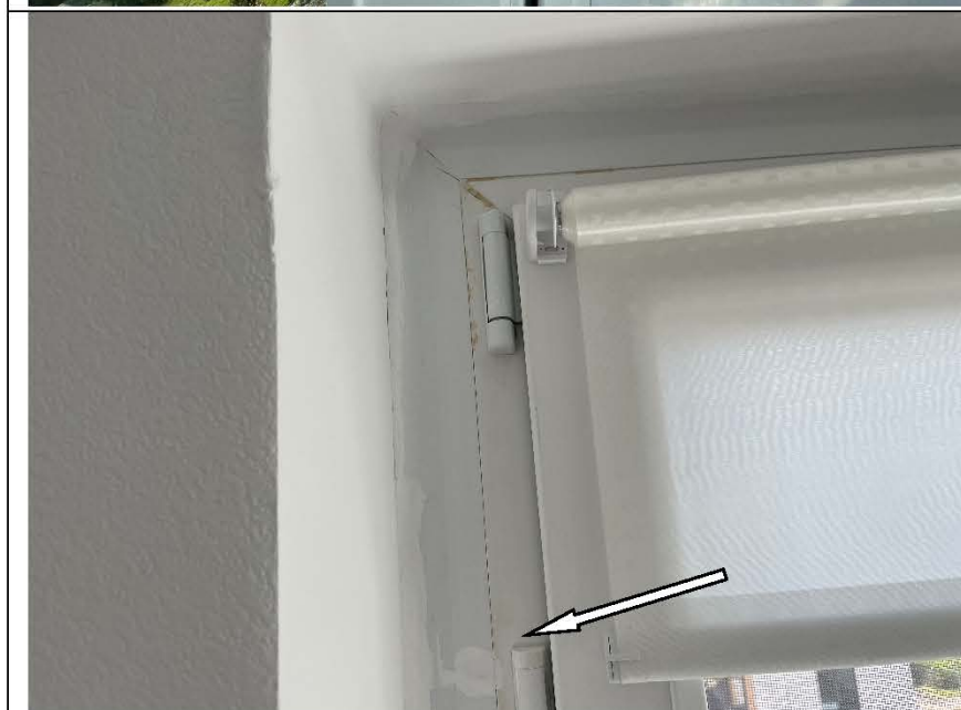
Фото №29. Загрязнение оконного блока ПВХ в спальне.
